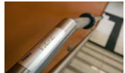
Figura 53. Sinalização de corrimão.
