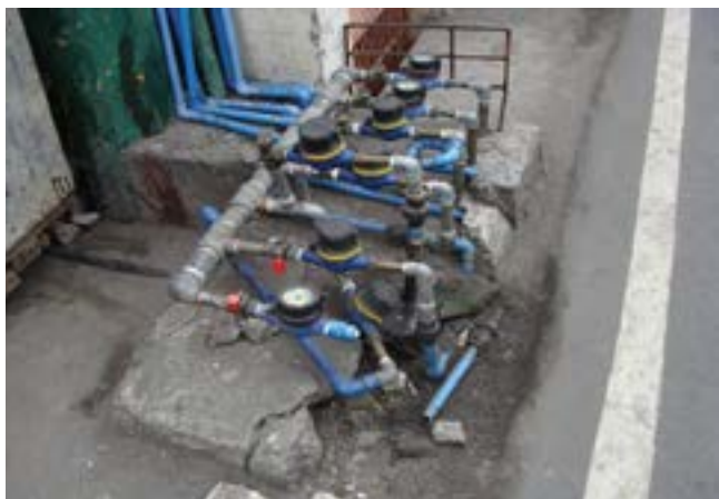
Figura 58. Manila, Filipinas: Tubos e medidores de válvulas de gás expostos.
