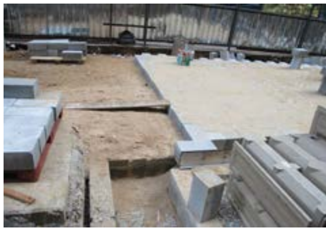
Figura 59. São Paulo, Brasil: Canais de drenagem em obras para um projeto de repavimentação de rua.
