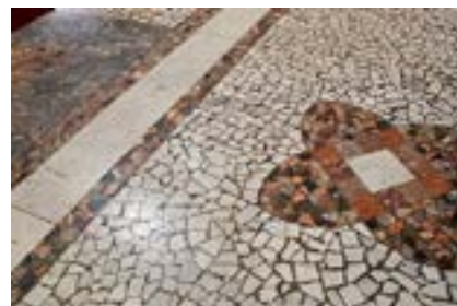
Figura 143. Pisos irregulares com texturas e cores irregulares.
