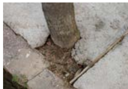
Figura 135. Plantio inadequado: Árvore plantada sem gola, destruindo calçada e criando perigo de tropeços.
