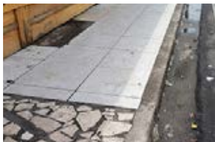
Figura 141. Cerâmica escorregadia e fora do padrão.
