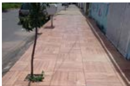
Figura 144. Cerâmica escorregadia e fora do padrão.
